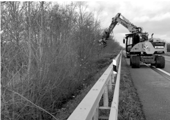
Gehölzbagger im Einsatz: Die drei Straßenmeistereien im Rhein-Neckar-Kreis schneiden derzeit die Gehölze entlang von Bundes-, Landes- und Kreisstraßen im Rhein-Neckar-Kreis zurück. (Foto: Landratsamt Rhein-Neckar-Kreis)
