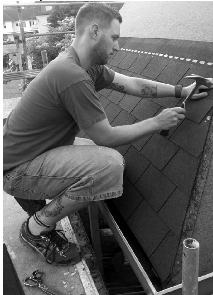
Ein Farbtupfer im alten Schulhof sind jetzt die roten Bitumenschindeln auf dem Dach des Fahrrad-Unterstandes
