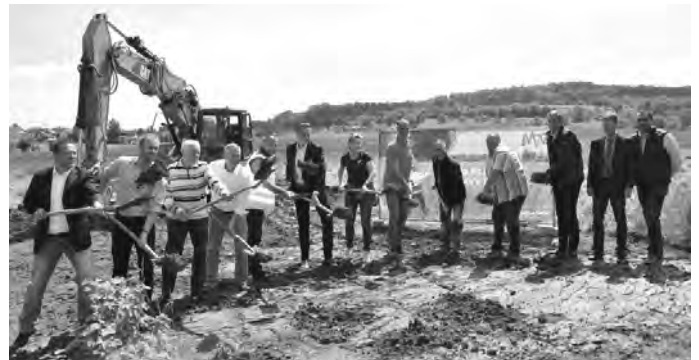
Vertreter der Gemeinde und der beteiligten Projektpartner geben mit dem Symbolischen Spatenstich den Startschuss für die Erschließungsarbeiten auf dem Neubaugebiet „Ambelwiesen II“
